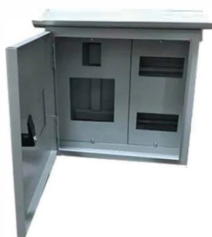
Средства учёта электроэнергии (счётчики) и измерительные щиты
