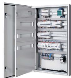
Этажные щиты и щиты освещения
