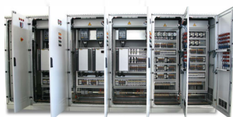
Панели управления и контроля двигателями (МСС)
